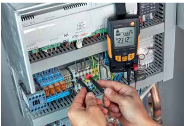
Проверка напряжения в распределительном щитке теплового насоса.
